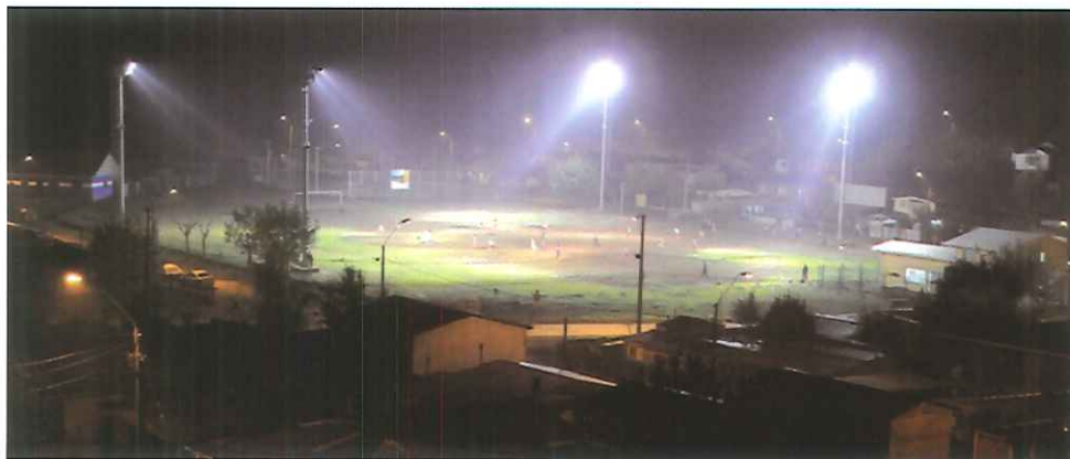
Torres de iluminación instaladas el 2010.
