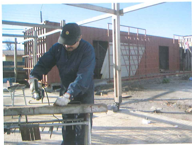
Construcción de Telecentro ubicado al lado de la sede vecinal, julio de 2010.
