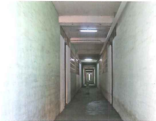
Iluminación pabellones Colectivos.
